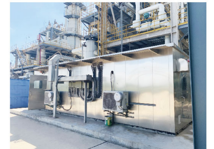
聚丙烯装置气体检测控制
